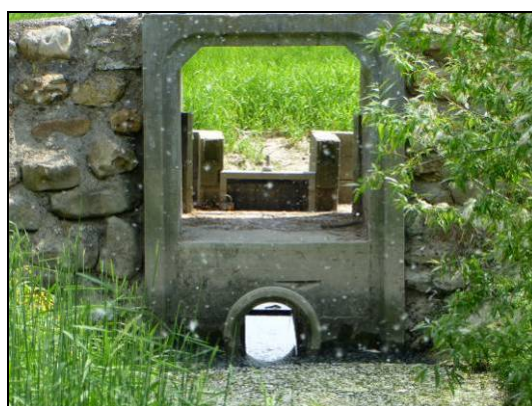
Photo 83. Ouvrage mobile et fixe : Buse et vanne levante.
