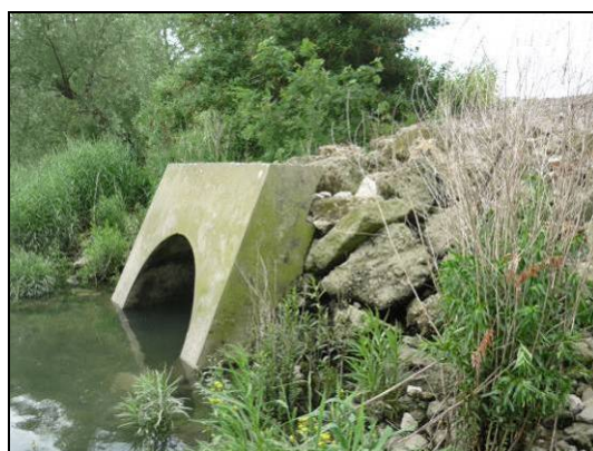
Photo 81. Ouvrage fixe : Buse.
