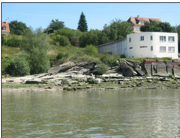
Photo 28. Berge revêtue très dégradée (Le Vieux trait).
