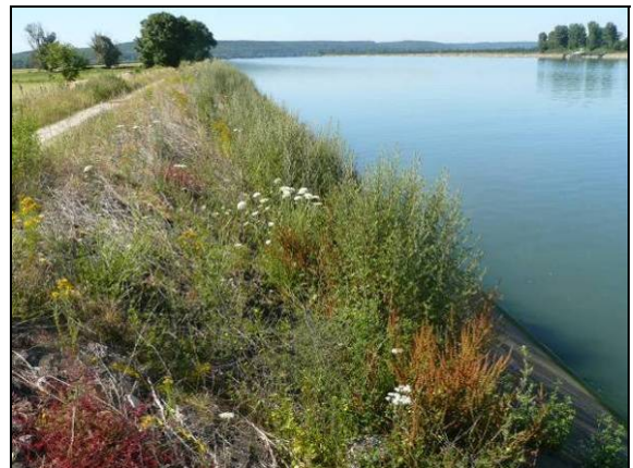
Photo 14. Berge moyennement dégradée (La Neuville).
