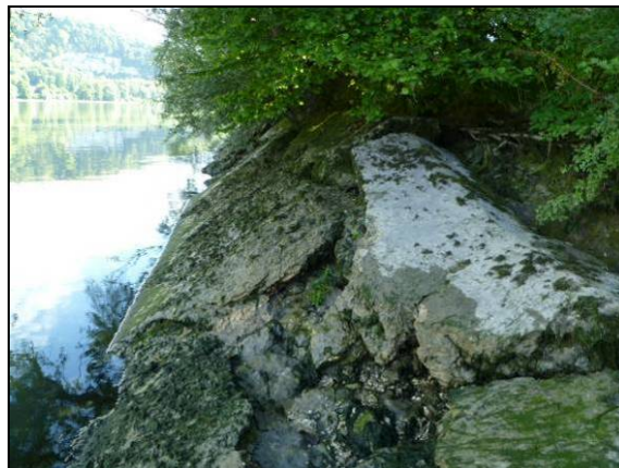
Photo 15. Berge très dégradée.
