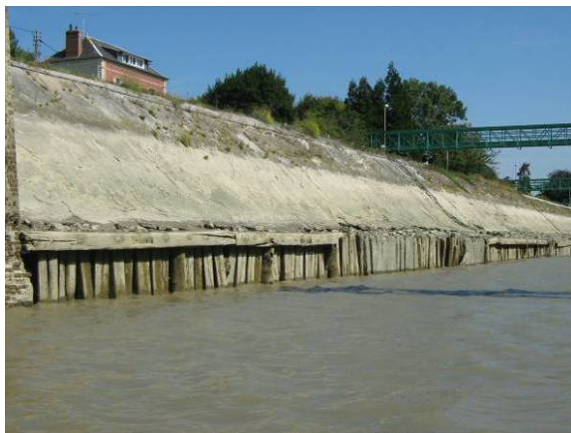
Photo 9. Exemple de protection du pied de berge : palplanche bois (Tancarville).
