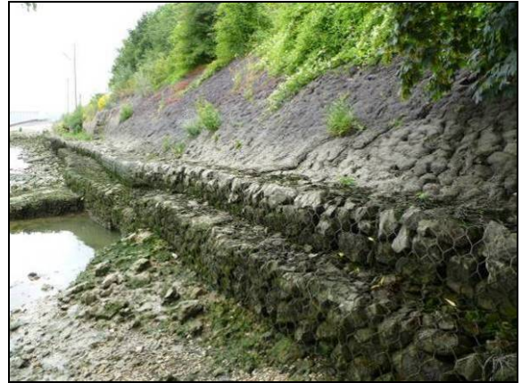
Photo 8. Exemple de protection du pied de berge : gabion matelas (Val de la Haye).
