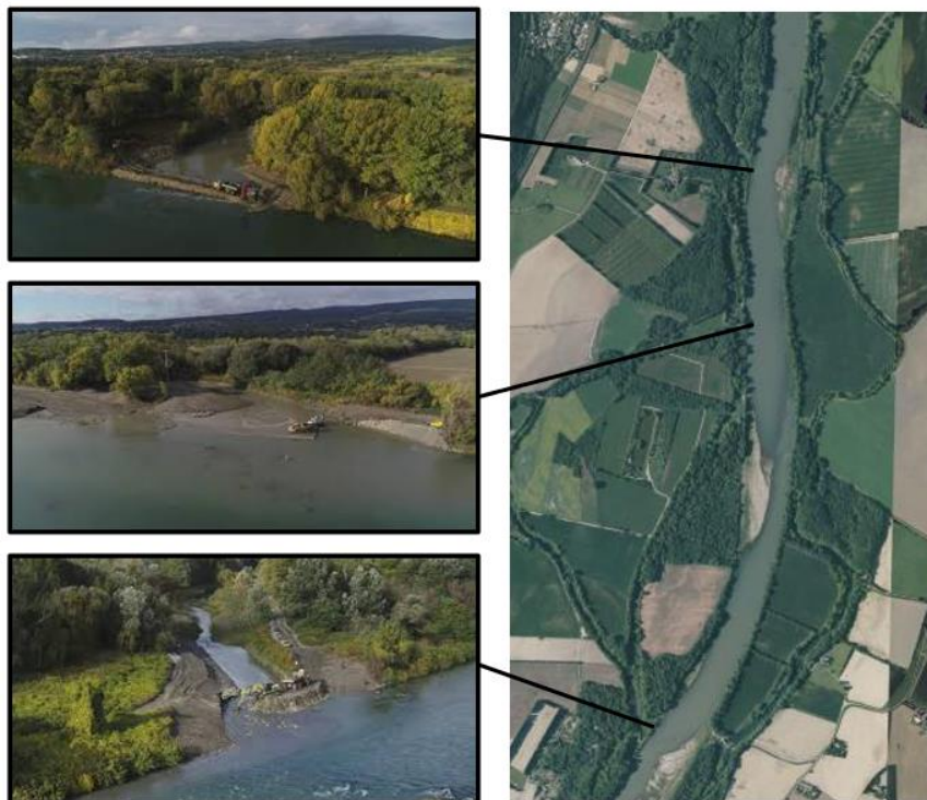
Figure 28. Travaux de restauration des annexes hydrauliques (lônes dans le secteur de Donzere) dans le cadre du plan de restauration du Rhône (crédit photo CNR)
